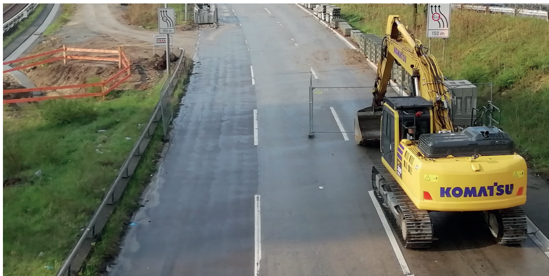
A 100: Bau ohne ausreichenden Anwohnerschutz
